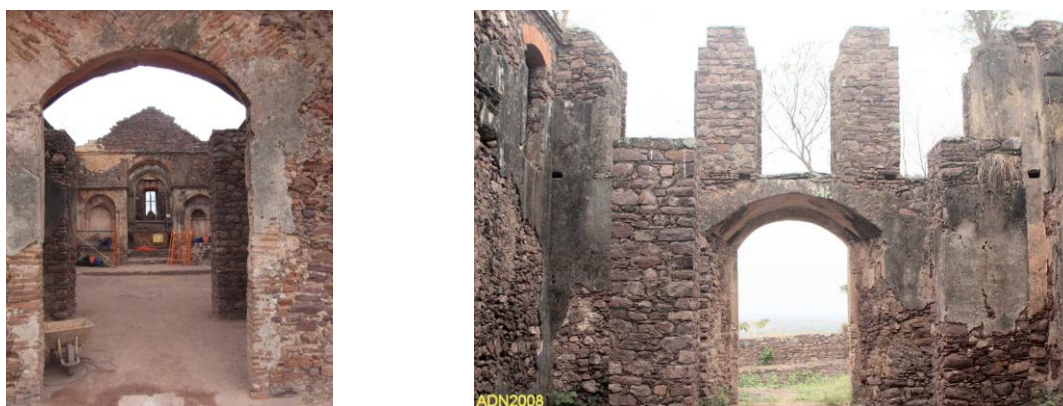
Figura 31 - Desagregação da alvenaria na fachada principal junto da entrada principal da Igreja no exterior (à esquerda [12]) e no interior (à direita [31]).
