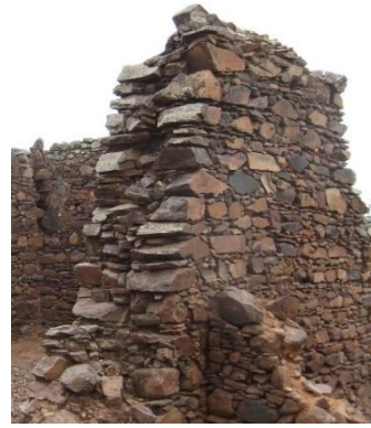
Figura 26 - Disposição das pedras sem colocação de elementos transversais. Esta parede diz respeito a uma construção independente da Igreja de N. Sr.ª do Rosário.
