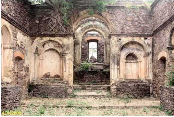
Figura 10 - Ruínas do interior da Igreja de Nossa Senhora do Rosário (2008) [31].
