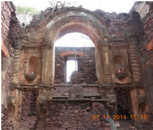
Figura 33 - Deformação da parede do altar [12].
