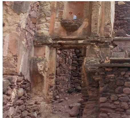
Figura 34 – Apoios deficientes da parede do altar devido vão aberto na sua base.
