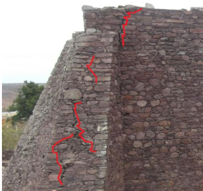
Figura 29 - Fendilhação na junção das paredes de tardoz e lateral direita e no respetivo contraforte [12].
