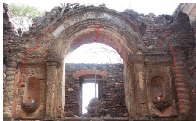
Figura 30 - Várias fendas visíveis na parede do altar [12].
