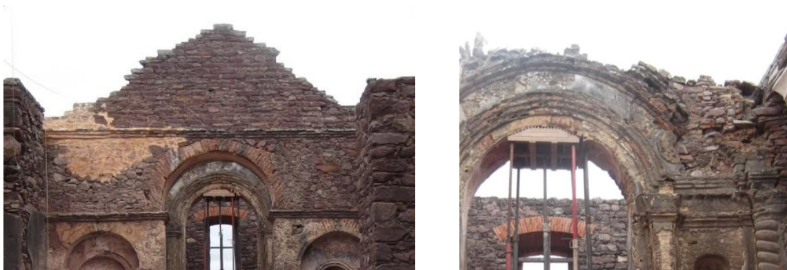
Figura 32 - Perda de elementos pétreos constituintes da alvenaria na parede entre a ante-câmara e a sala do altar (à esquerda) e na parede do altar (à direita) [12].
