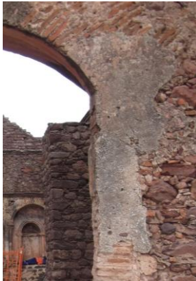
Figura 27 - Diferentes tipos de argamassas de revestimento na parede junto da entrada principal da Igreja [12].
